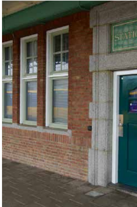
Afb. 4 (links boven) Deel van het muurwerk van School I aan de Oosterstraat in Deventer uit 1894, waar door de lichte kleur baksteen de vallende tand goed zichtbaar is.
