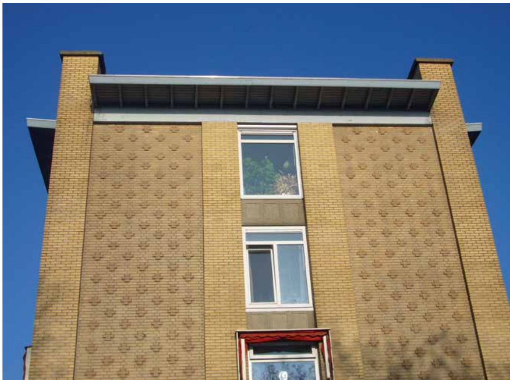
Afb. 21 Kopwand van één van de flats aan het Tolsteegplantsoen in Utrecht uit 1957, van gele vacuümstrengperssteen met ter versiering lichtelijk uitstekende bakstenen in kruisvorm.
