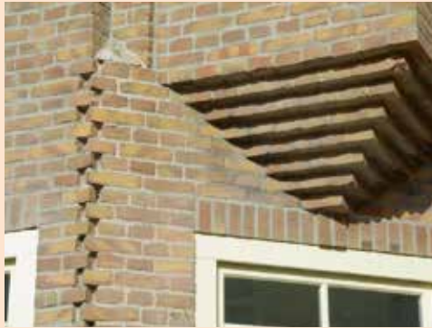
Afb. 37 (rechts boven) Doorstekende baksteen op een stompe hoek van een erker aan de Mesdagstraat 12 te Den Haag uit circa 1920.
