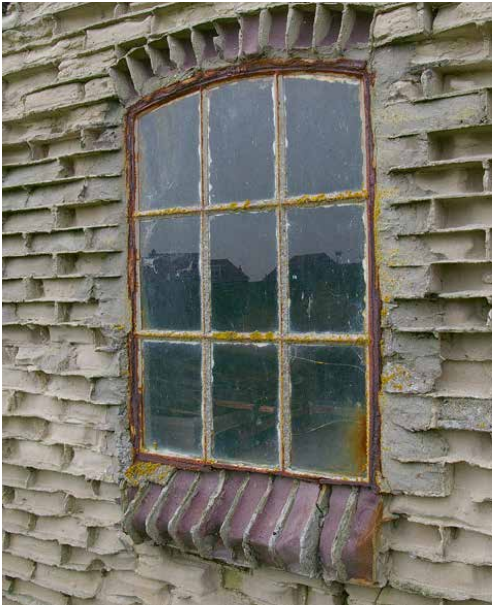
Afb. 13 Detail van het zogeheten 'zouthuisje' te Laaksum aan de Friese kust bij de voormalige Zuiderzee, waarvan de kalkzandsteen sterker is verweerd dan de cementvoeg.
