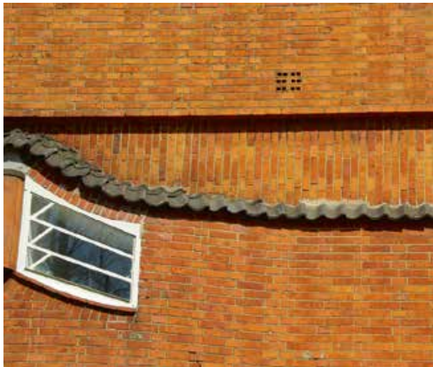
Afb. 12 (rechts) Detail van het gevelwerk van het Derde Blok van de Woningbouwvereniging Eigen Haard, opgetrokken uit onbezande Groninger strengperssteen waarvan er enkele gedraaid zijn om als ventilatiesteen te dienen voor de achterliggende spouw.
