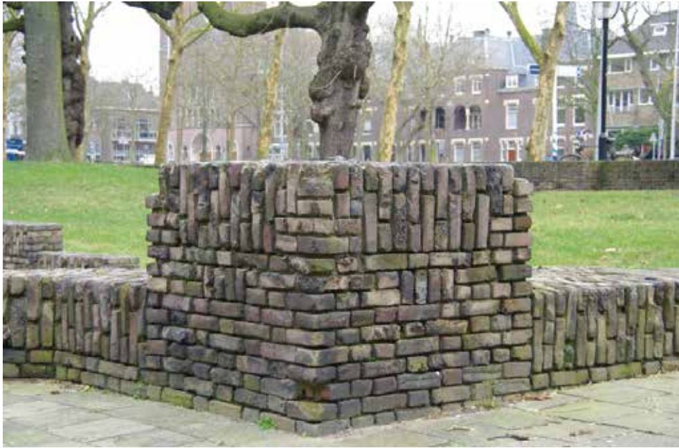
Afb. 2 Tuinmuur vóór het Hoofdgebouw III van de Nederlandse Spoorwegen aan het Moreelsepark in Utrecht, opgetrok- ken uit mondsteen waarbij de gedeeltelijk gesmolten toestand van de steen nog goed zichtbaar is.
