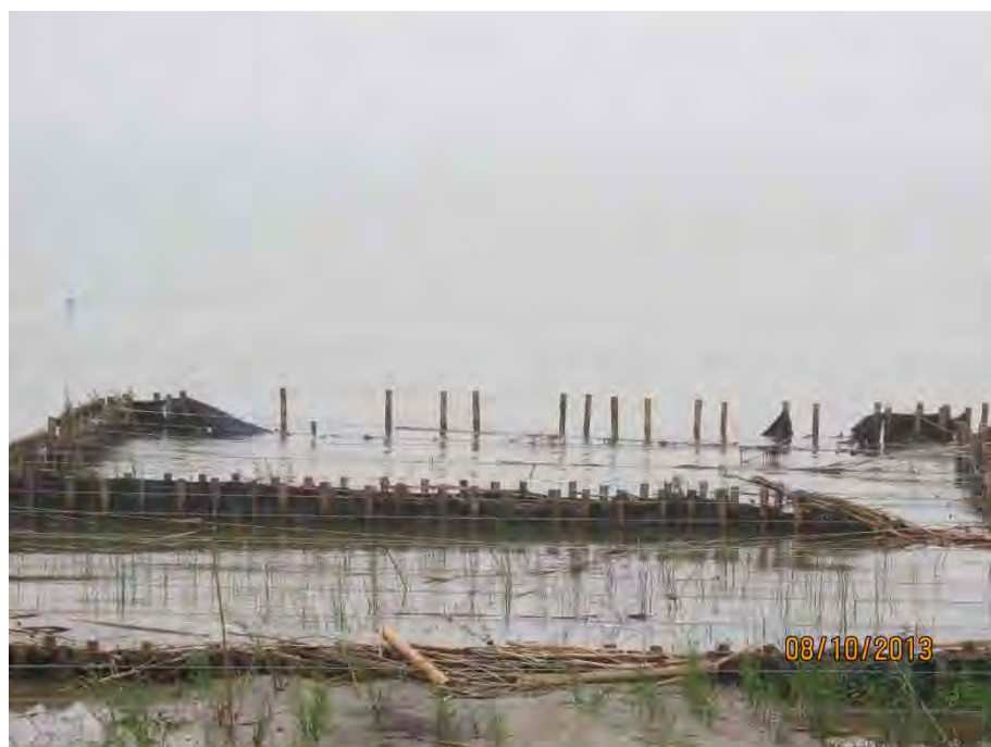
Zand 6, schade oostzijde vak c
