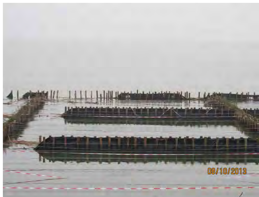
Zand 5, schade oostzijde vak c
