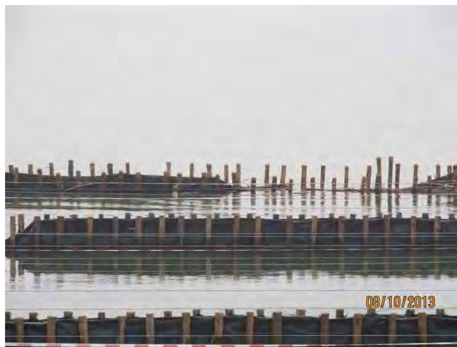
Slib 2, schade oostzijde vak c
