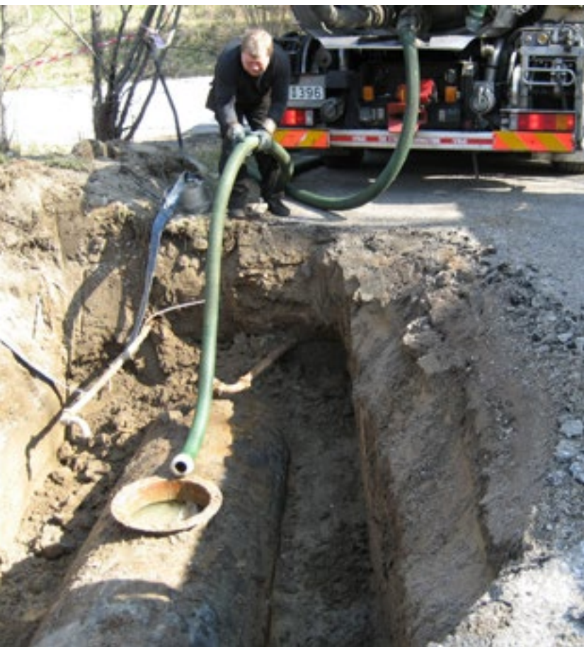
Tömning och rengöring av produktfylld cistern via ADR-bil.
